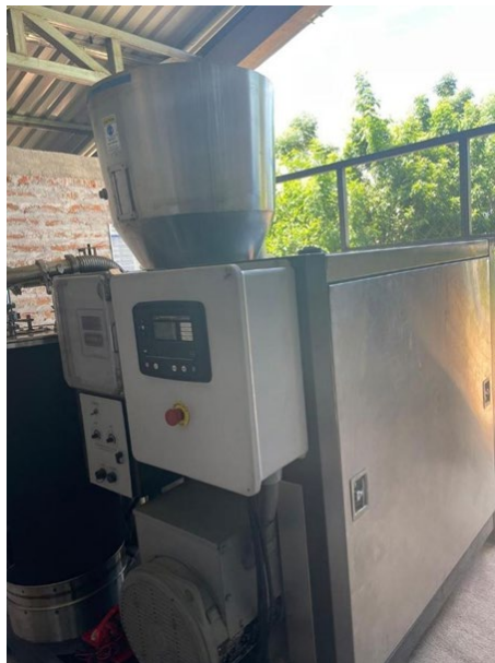
Figura 15. Gasificador de Biomasa Instalado en Ambas Comunidades.
