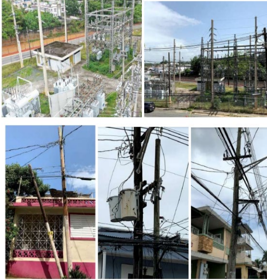
Figura 8. Subestación y distribución eléctrica, fotos: (F.A.R)
