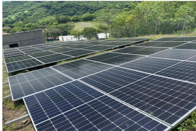
Figura 14. Central FV en Torrecilla.
