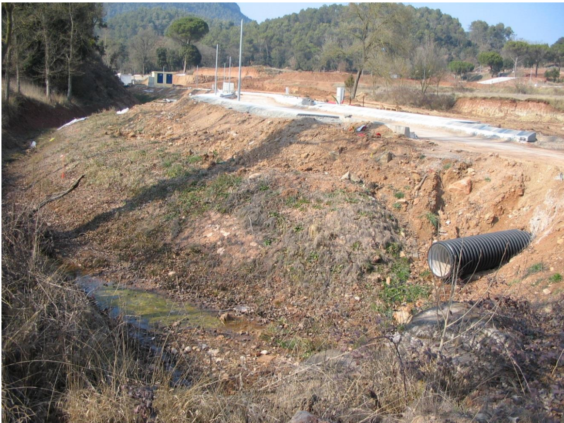
Canalización de las aguas pluviales en el Passatge de les Avellanedes , hasta la Riera del Oller
