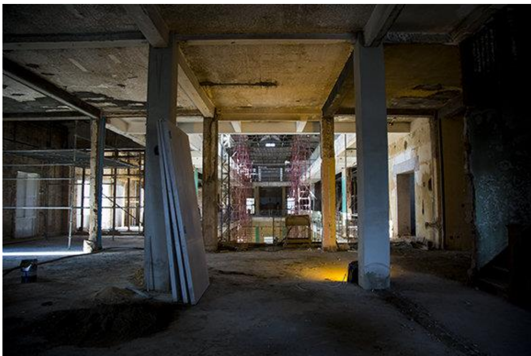
Figura 101. Estado del atrio y sala de espera de la Estación Central de Ferrocarriles de La Habana. Febrero de 2019. Fuente: (Figueredo y Pérez, 2019)
