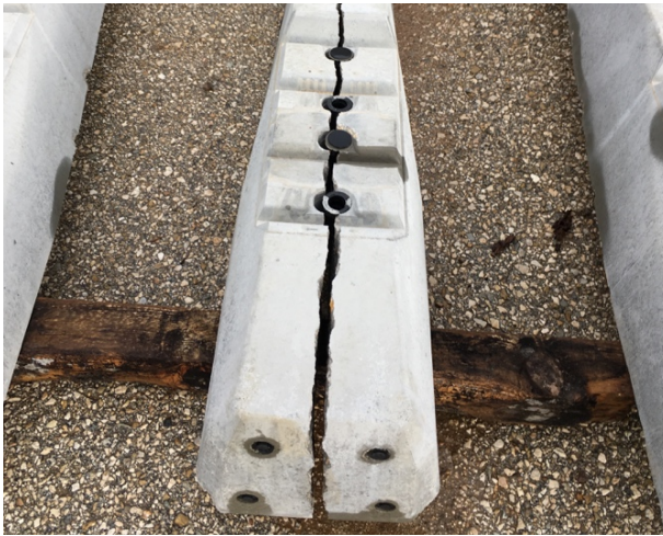
Figura 1. Fisuración longitudinal según el plano del eje de simetría vertical.
