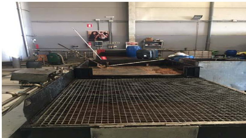
Figura I.15. Equipo de filtración.
