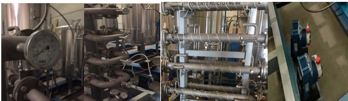
Figura MM 15: Manómetro, vacuómetro, termómetros, resistencia y bombas dosificadoras
