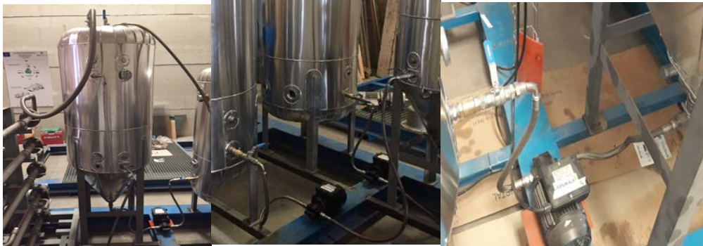
Figura MM16: Decantador con conexiones y bombas de trasiego.
