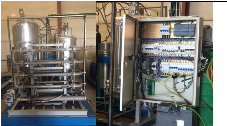
Figura MM 14 Reactor y procesador con drive en el cuadro eléctrico
