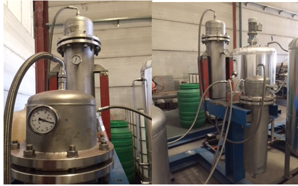
Figura MM20: Columna de depuración y filtros cesta.
