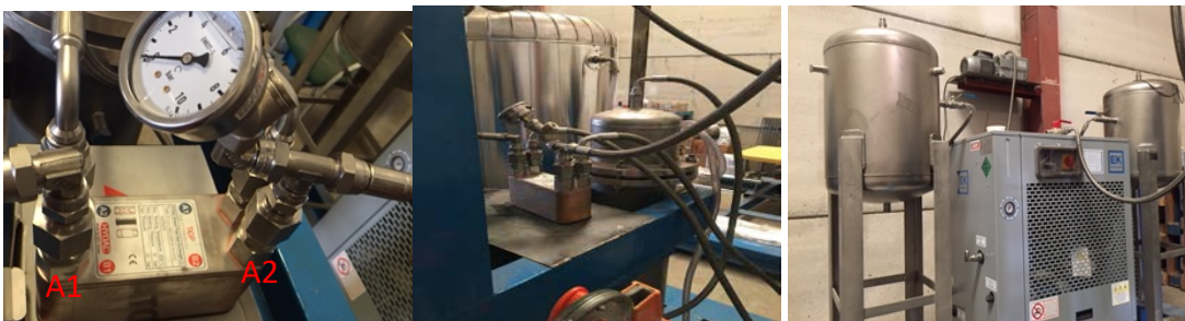
Figura MM21: Condensador de placas, pulmones, enfriador y bomba de vacío.
