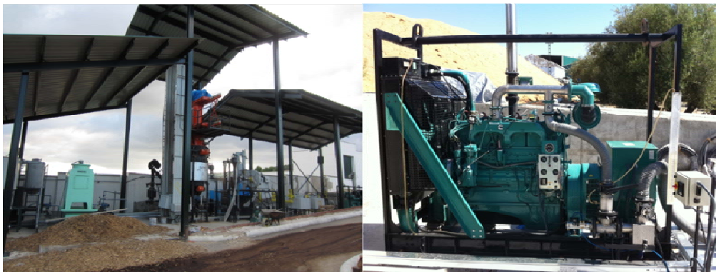
Figura 2.6. Planta de gasificación (izquierda) con motor de gas Cummins® G855G (derecha) alimentado con gas de síntesis procedente de la gasificación de biomasa.
