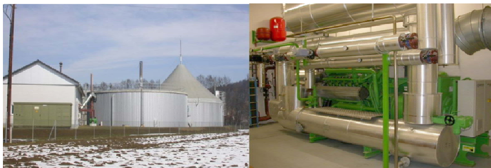
Figura 2.7. Planta de biogás procedente de la digestión anaerobia de estiércol (izquierda) con motor de gas Jenbacher® (derecha).
