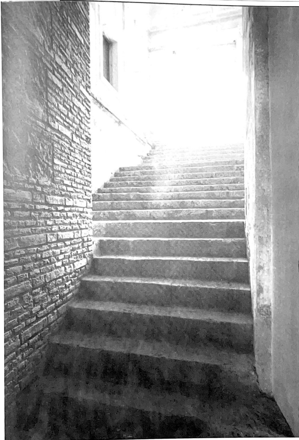
9. Peldaños de la escalera del zaguán norte, estado actual. Foto: Valentín García Baca
