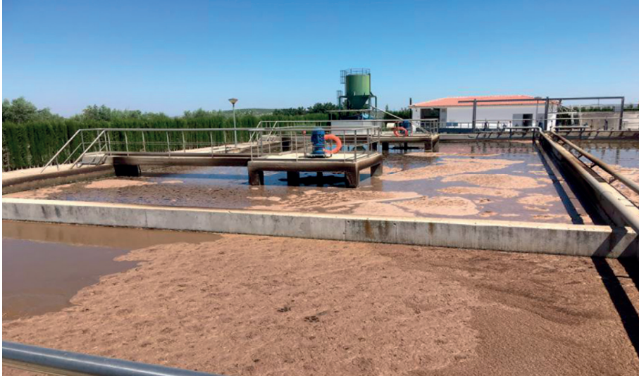
FIGURA 1 EDAR de Torredelcampo
