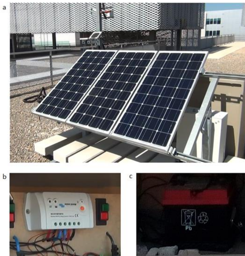
FIGURA 1: SAPV instalación del sistema de Jaén: (a) módulo PV mono-cristalino, (b) controlador y (c) de la batería de plomo-ácido de carga.
