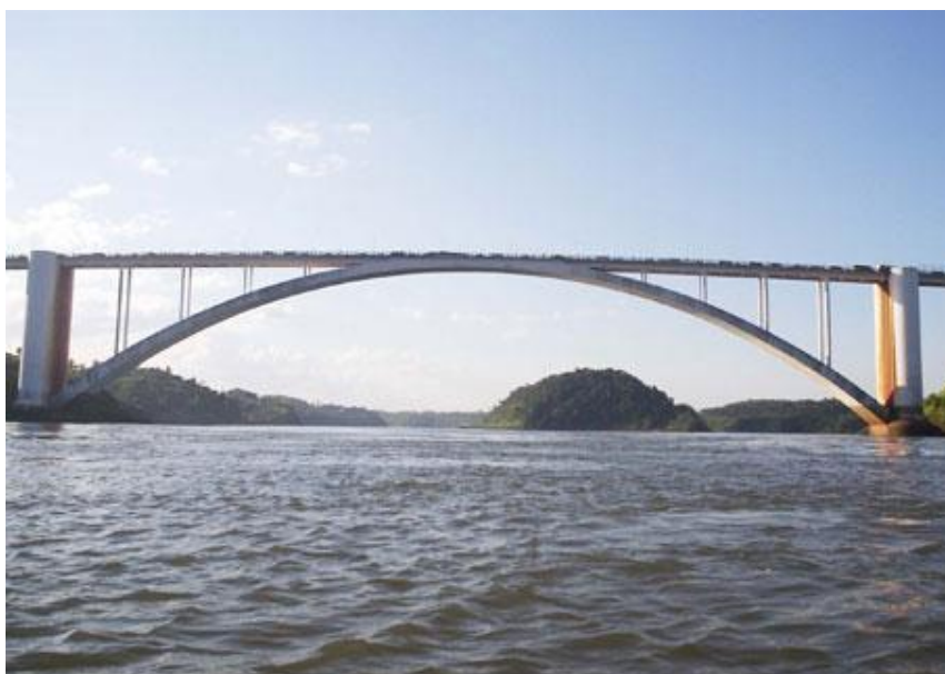
Figura 2. Puente de la Amistad, sobre el Río Paraná, que une Paraguay y Brasil
