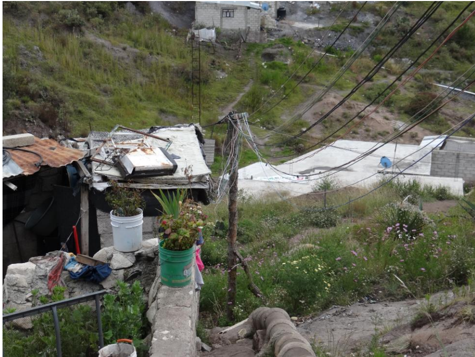
Improvisación de postes para sostener los cables de luz eléctrica.
