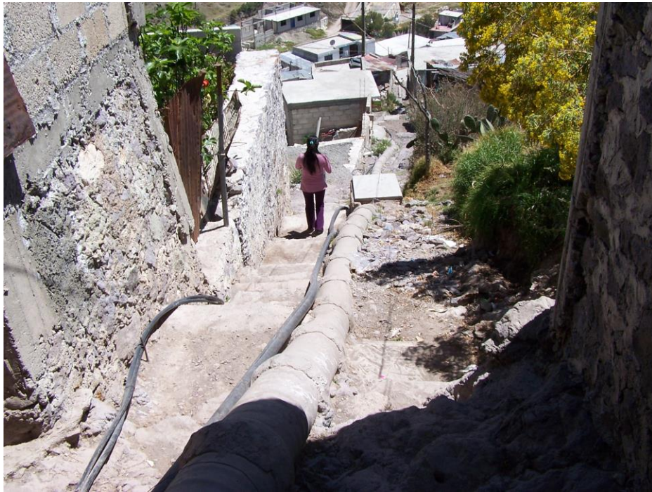
Las tuberías del drenaje y las mangueras que transportan el agua están en la superficie.
