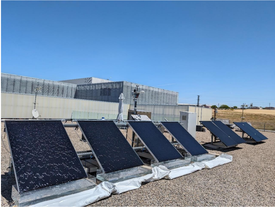
Figura 8.2. Instalación a gran escala para el estudio de la nueva tecnología Open SolWat en la azotea de la EPS de Linares.
