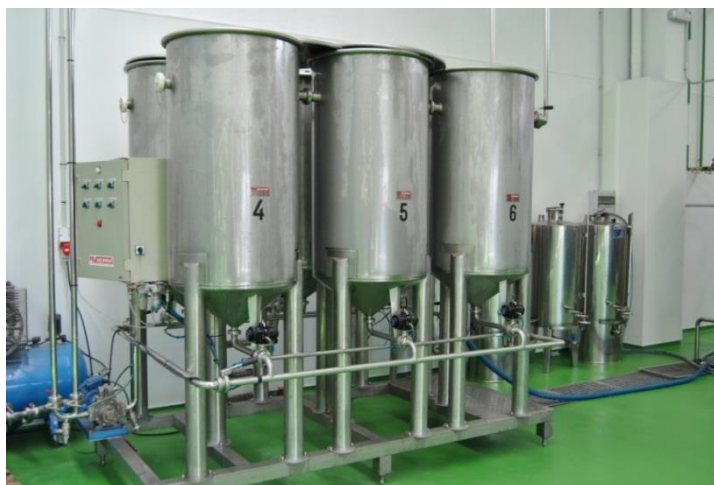
Figura 1.8. Batería de decantadores con fondo cónico en el Centro IFAPA, Mengíbar (Jaén).
