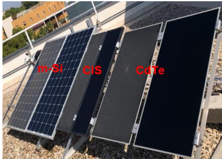
Fig. 25. Instalación experimental de soiling situada en la azotea del edificio C6 en el campus de las Lagunillas (Universidad de Jaén).
