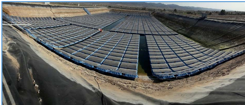
Figura 8. Compatibilidad del sistema con variaciones de nivel de agua y vaciado, y apoyo del sistema en los taludes de la balsa.
