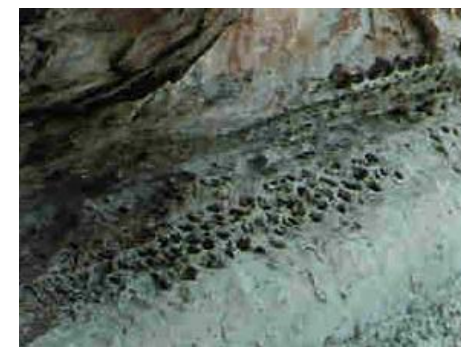
Imagen 256.- Oquedades realizadas por fauna nociva. Fotografía Jorge Porras A.
