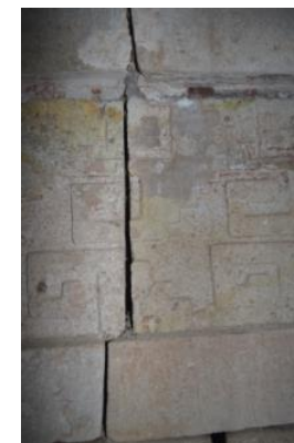
Imagen 259.- separación en muro. Fotografía Jorge Porras A.
