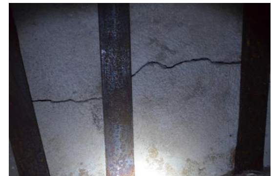
Imagen 241.- Falla estructural de la cubierta de la
