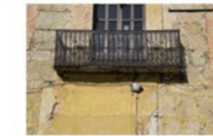
DAÑOS: Decoloración, Disgregación sacaroidea, Coloración, Descochadura y Mancha de humedad.
