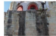
DAÑOS: Mancha de humedad, Avelización, Costra negra, Decoloración, Pétna de osalato, Planta, Microdescamación y Coloración.
