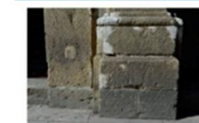
DAÑOS: Desconchadura, Pátina ferruginosa, Perforación y Excoriación.
