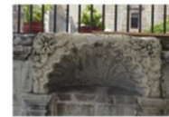
DAÑOS: Erosión diferencial, Fisura y Costra negra.
