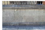
DAÑOS: Enmugrecimiento, Avelización, Liquen, Descamación perimetral y Tinción.
