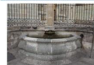
DAÑOS: Enmugrecimiento, Decoloración, Pérdida de matriz y Patina de óxido.
