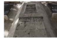
DAÑOS: Mancha de humedad y Alveolización.
