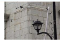
DAÑOS: Erosión y Flaura.
