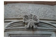
DAÑOS: Desconchadura, Decoloración, Enmugrecimiento y Avelización.
