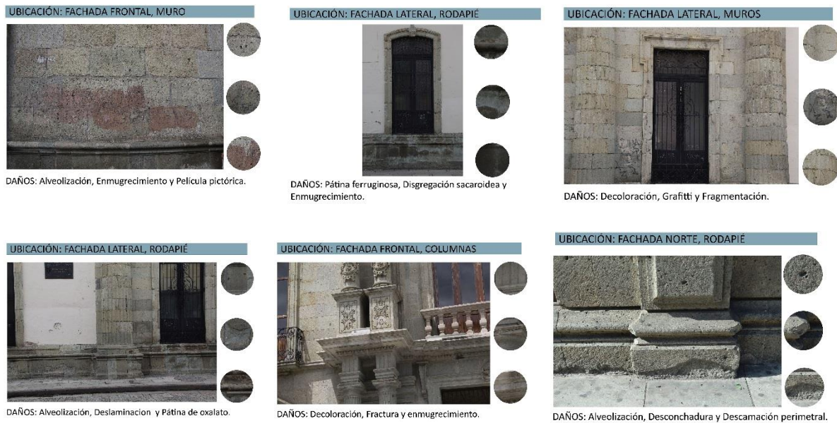
Figura 3.6. Diferentes tipos de daños que se presentan en la Arquitectura de Piedra Cantera en la Ciudad de Oaxaca, ejemplo presentado el edificio del Instituto de Ciencias y Artes, ubicado en Av. Independencia esquina Macedonio Alcalá S/N. Fuente: el autor.
