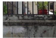
DAÑOS: Costra negra, Fragmentación y Alveolización.
