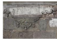
DAÑOS: Patina de óxido, Alveolización, Película pictórica, Pitting, Descamación perimetral, Decoloración y Graffiti.
