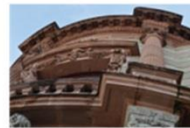
DAÑOS: Mancha de humedad y Fragmentación en esquinas.
