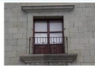
DAÑOS: Ennegrecimiento y Decoloración.
