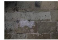
DAÑOS: Cuatro negro, Película pictórica, Enmugrecimiento, Patina de óxido y Alveolización.
