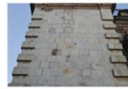
DAÑOS: Ennegrecimiento, Coloración, Mancha de humedad, Pátina de oxalato, Fisura y Desconchadura.
