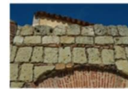
DAÑOS: Erosión diferencial, Ennegrecimiento, Decoloración y Perforación.
